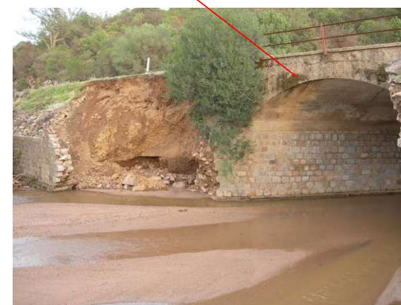
SP1 Ponte in prossimità della Caserma della Forestale. Il corso d'acqua ha tracimato l'opera d'arte erodendo il rilevato a valle e provocando lo scalzamento dei muri
