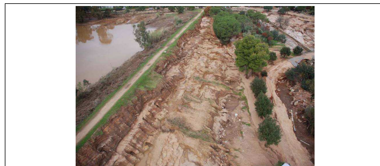
Figura 68 – Stato dello sbarramento il 25 ottobre 2008.
