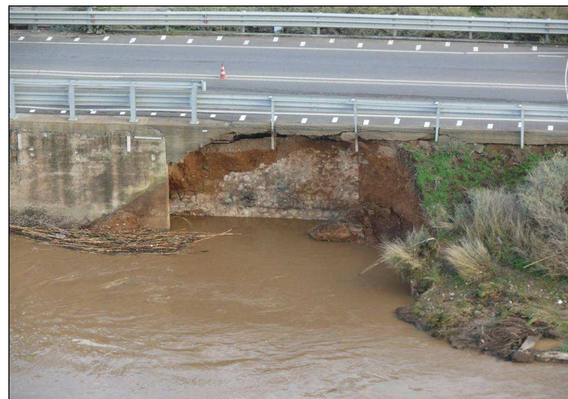
Figura 79 - Cedimento del rilevato stradale
